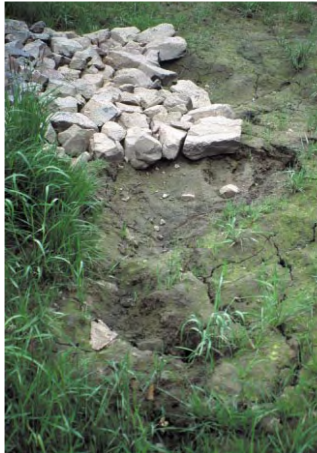
Erosionsschäden in Mutterbodenschicht
