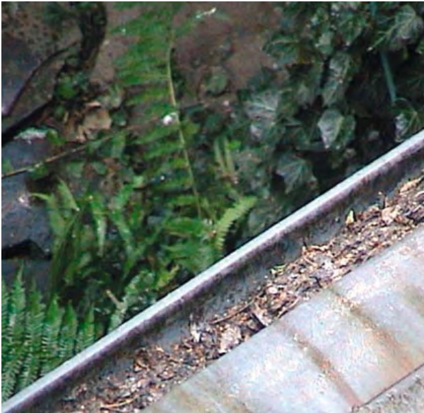
Ablagerungen in Dachrinne
