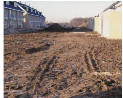
Spuren von Baumaschinen in den mit Oberboden vorprofilierten, zukünftigen Versickerungsanlagen
