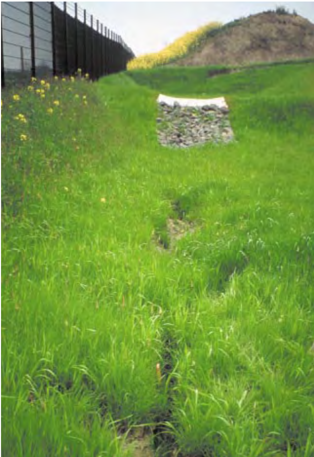
Zerstörte Mutterbodenschicht in Mulden-Rigole, Niederschlagswasser, mitgeführte Schadstoffe und Mutterboden werden in Rigole eingeschwemmt
