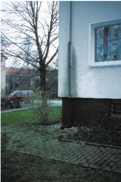
Feuchteschaden in Folge abgerutschten Fallrohres
