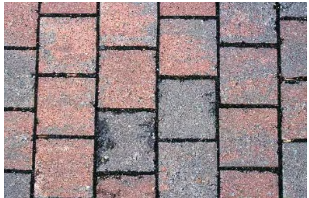
Sickerfugenpflaster 8 Jahre alt vor Reinigung
