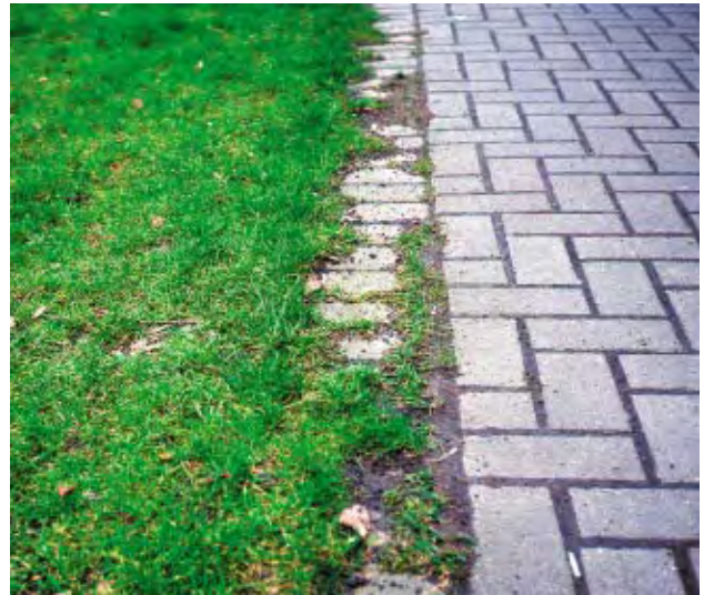
Wulstbildung im Übergangsbereich befestigte/unbefestigte Fläche
