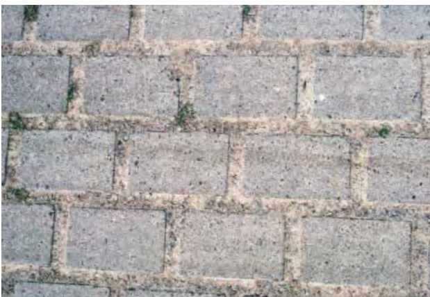
Rasenfugenpflaster – zerstörte Vegetation, keine Versickerungsleistung
