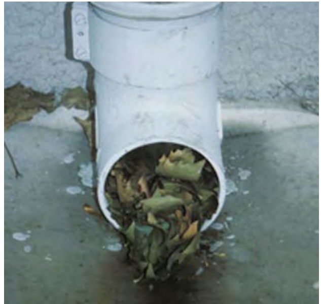
Ablagerungen aus der Dachrinne im Fallrohr
