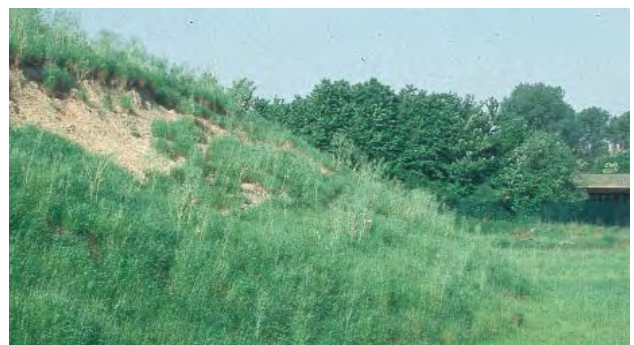
Mulden-Rigole durch unzureichend gesicherte Böschung geschädigt
