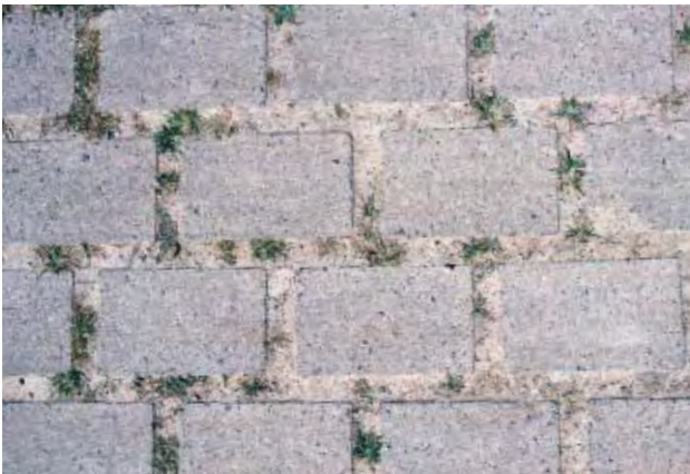
Rasenfugenpflaster – geschädigte Vegetation, reduzierte Versickerungsleistung
