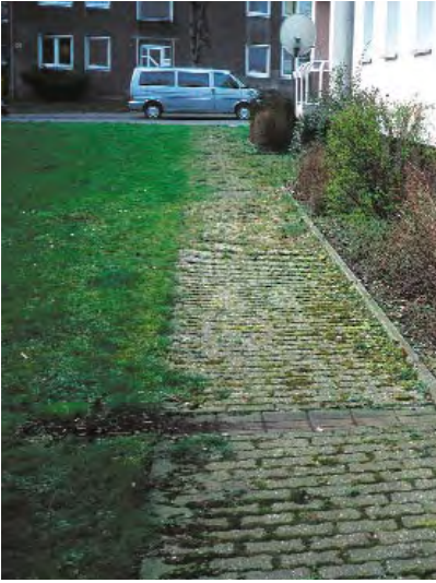
Ablagerungen von Laub und Sedimenten an Rinnenende
