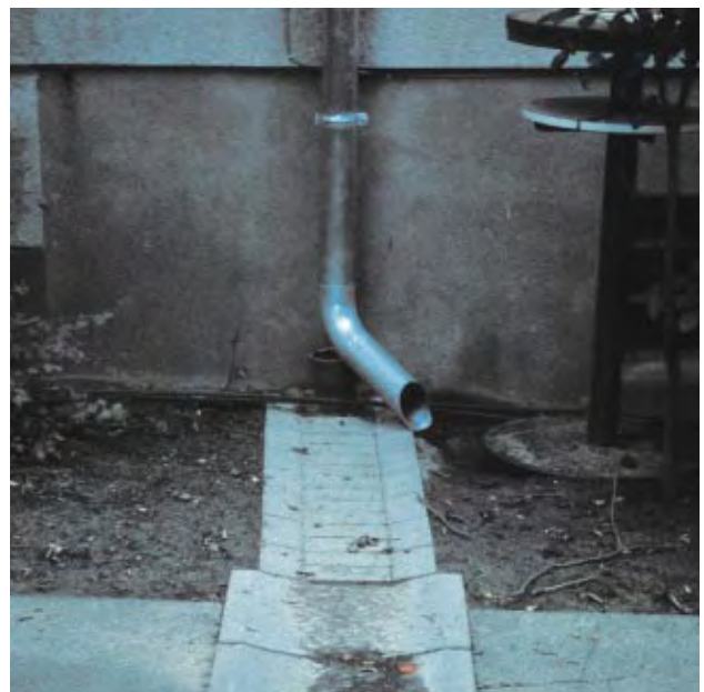
Fallrohrkrümmer aus Zinkblech. Fehlende Fixierung birgt die Gefahr der Fehlableitung (Feuchtschäden Keller).
