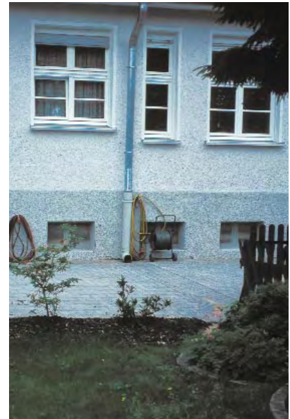
Fallrohr direkt auf Betonpflasterrinne aufgestellt
