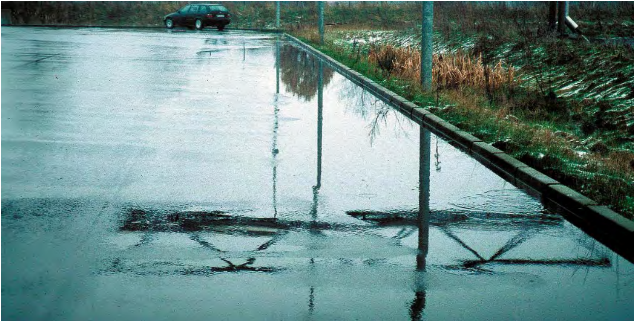
Wasserrückstau wegen verstopfter Ableitungslücken im Hochbord
