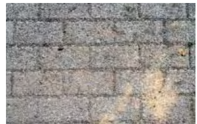
Verschmutzter Pflasterbelag (Lehm)
