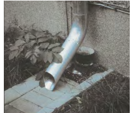
Mangelnde Rinnenabdichtung im Anschlußbereich Hauswand
