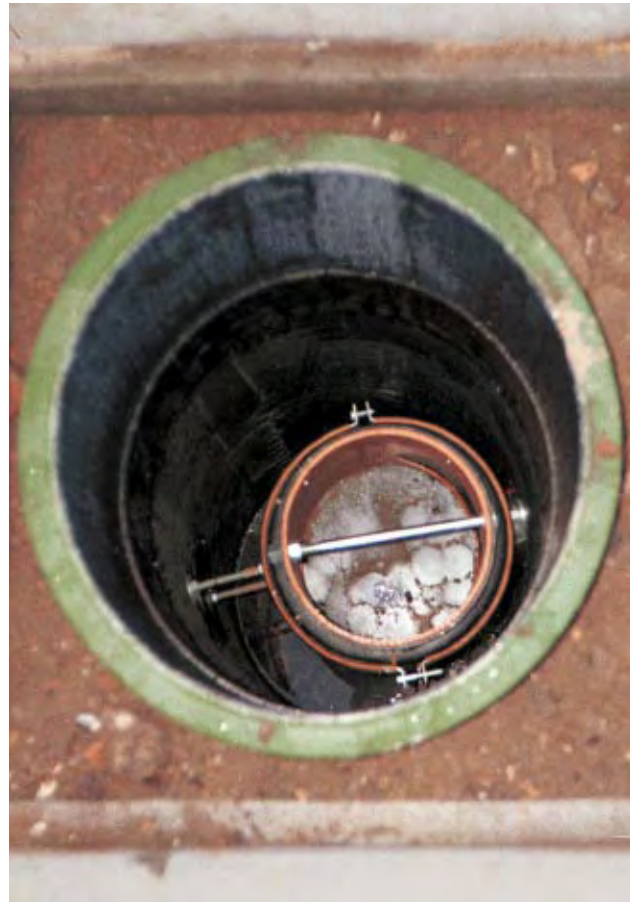
Drosselschacht mit überfahrbarer Einfassung/Abdeckung in Betrieb
