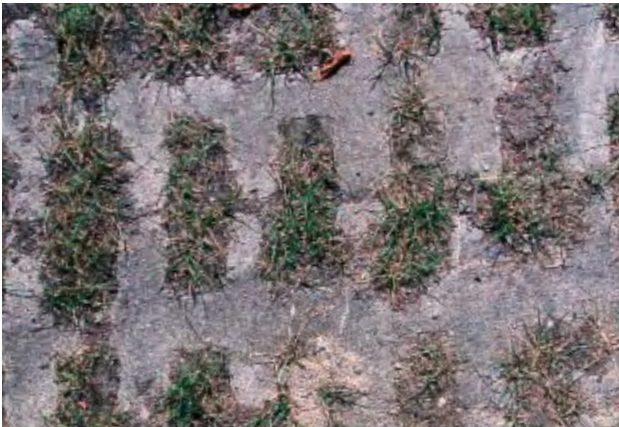
Rasenkammerstein – verschmutzte / verdichtete Rasenkammer, verringerte Durchlässigkeit
