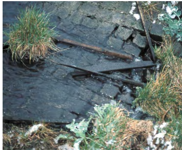
Auswaschungen im Pflaster gefährden die Standfestigkeit
