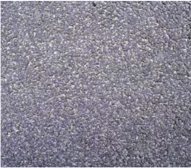
Dränasphalt verschmutzt - verminderte Versickerungsleistung
