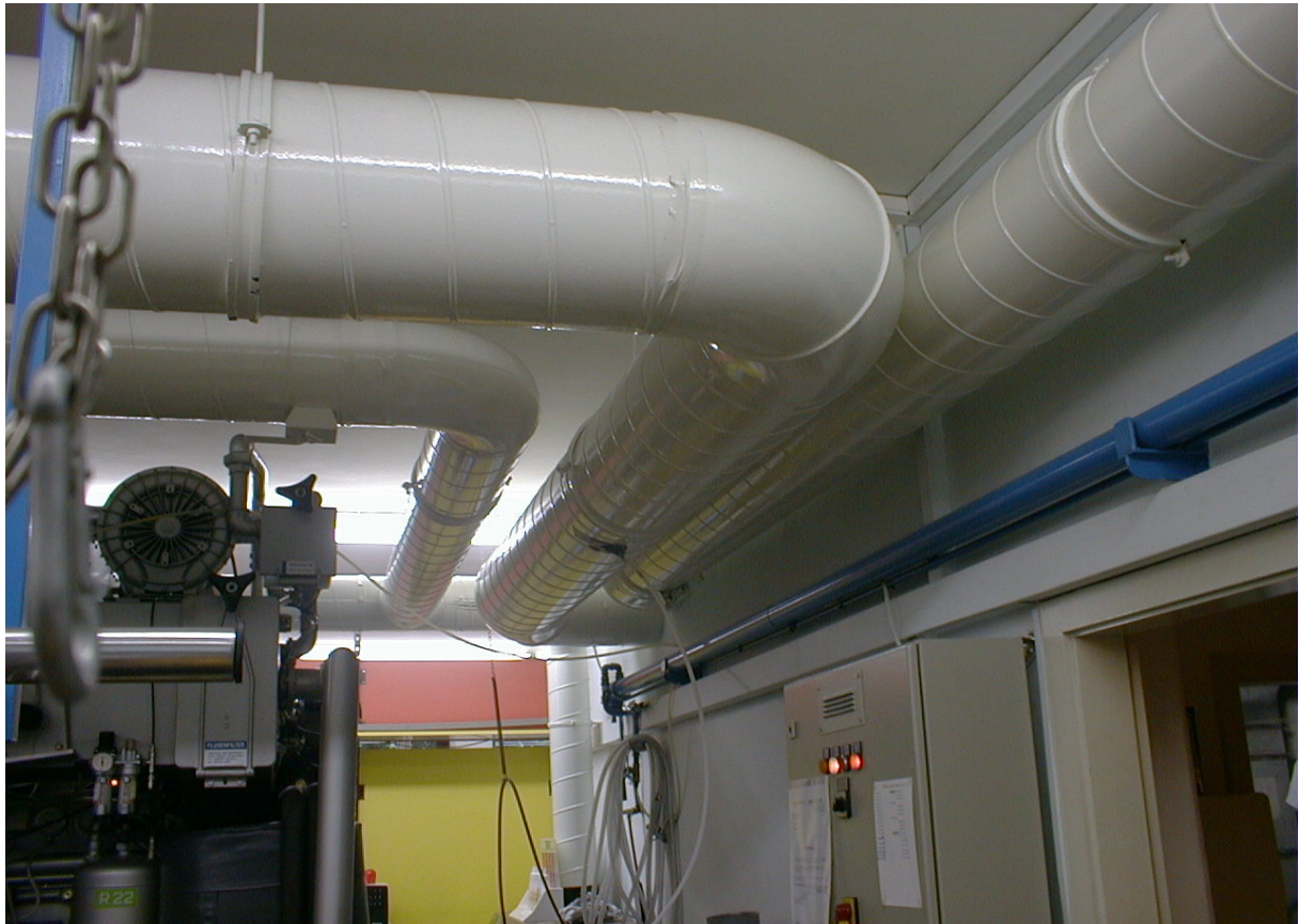
Bild 5: Abluffführung in der Chemischreinigung
