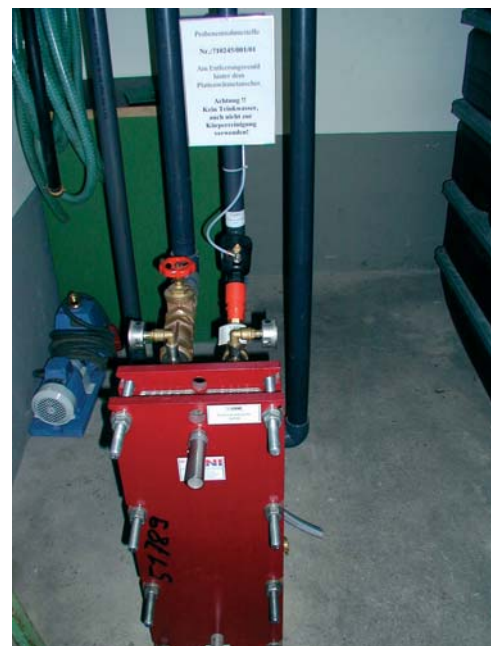
Bild 3: Kennzeichnung der Probenahmestelle (Messstellen-Nummernschild)
