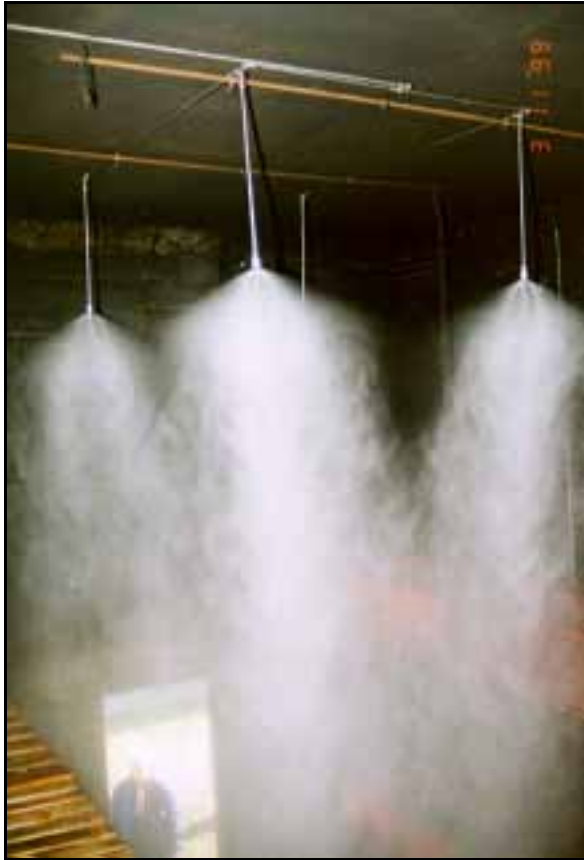
Bild 2.4: Blick auf die Löschanlage bei einem Sprühversuch
