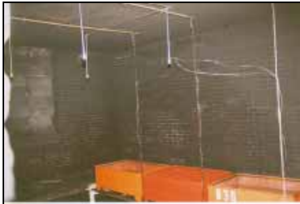
Bild 2.3: Blick auf die Löschanlage
