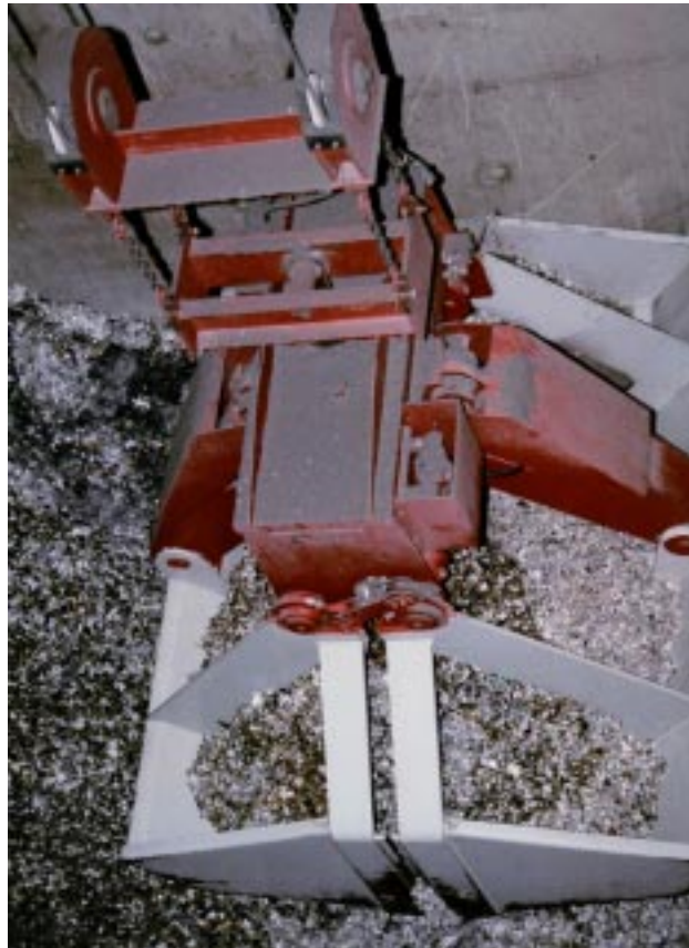
Bild 10: Vollautomatischer Greifarm im Sekundärbrennstoffbunker
