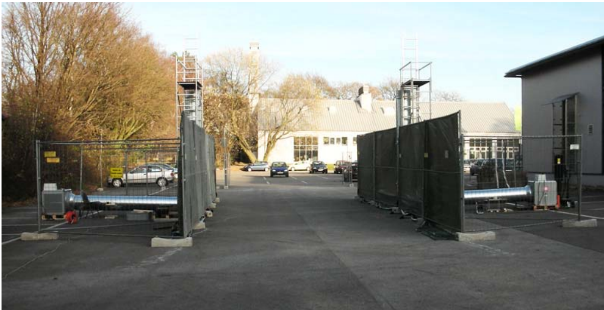
Abbildung 3: Durchfahrt mit seitlich installierten Absaugungen
