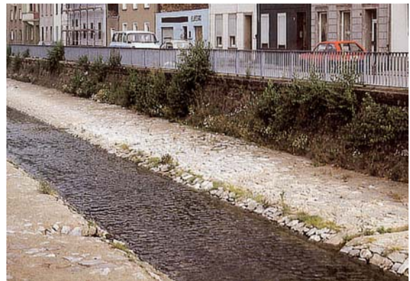
Massivsohle mit Sediment
