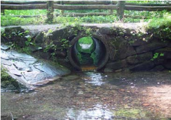
kleiner Absturz (0,1 - 0,3m)
