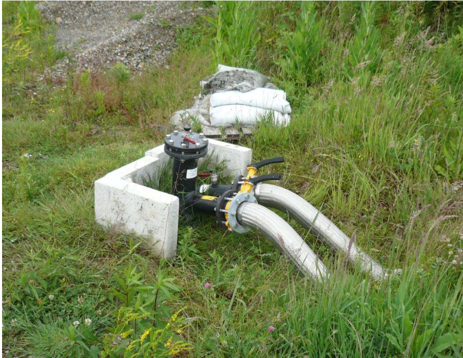
Abbildung 14 Gasbrunnen für eine Aerobisierungsmaßnahme
