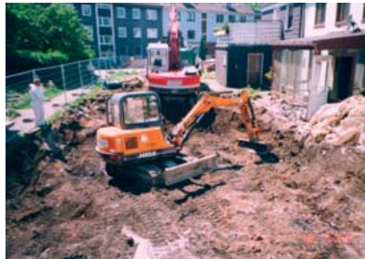
Abbildung 3.31: Beim Aushub übernimmt ein Minibagger die Feinarbeit. Der Mobilbagger belädt die Lkw. Um Staubbildung zu vermeiden, wird bewässert.
